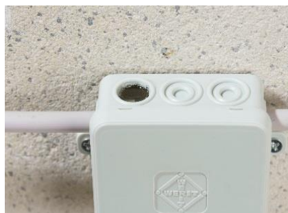
7. Kompletten Abzweigkasten mit ISO FLEX Gel befüllen. Nach ca. 50 Minuten ist das ISO FLEX Gel getrocknet und ausgehärtet
