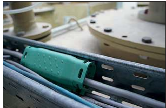
Gel-Kabelgarnitur Relifix V als Kabelverbindung.
